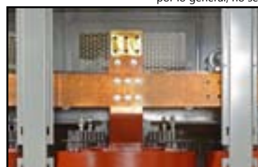
Barras colectoras de bajo voltaje
