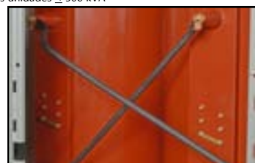
Conexiones del primario
